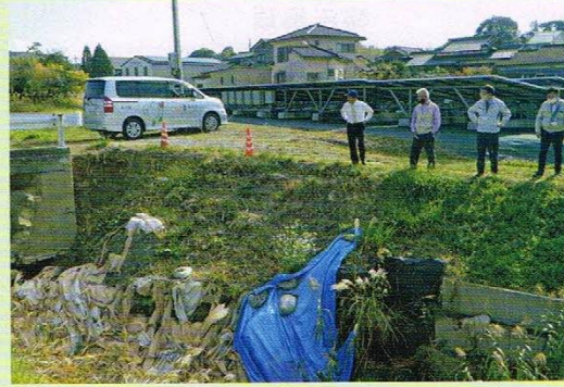
2020年11月17日 広川町高間長延川護岸崩壊
