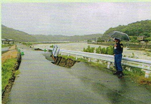
2020年7月7日 山内星野川護岸崩壊
